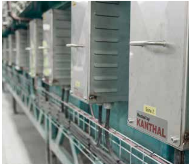
Den elektriska ugnen har minskat energiförbrukningen med 37 procent och koldioxidutsläppen till noll.
